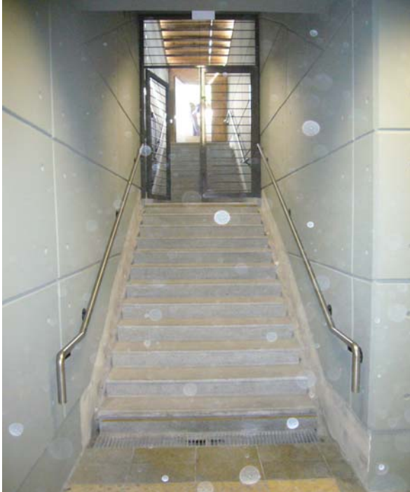
Foto 1- Tronera de acceso a Estación Echeverría, no cuenta con revestimiento adecuado, lo que requiere constante mantenimiento.
