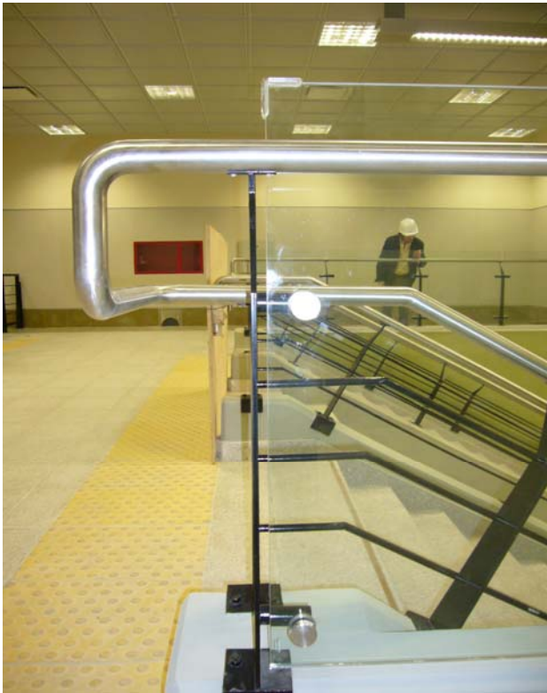
Foto 3- Falta de redondeado en los cristales de las barandas.
