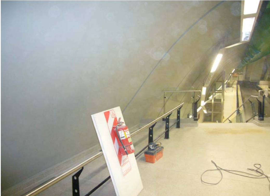
Foto 7- Inadecuada resolución proyectual en el encuentro del vestíbulo con la bóveda. Espacios inaccesibles y residuales.
