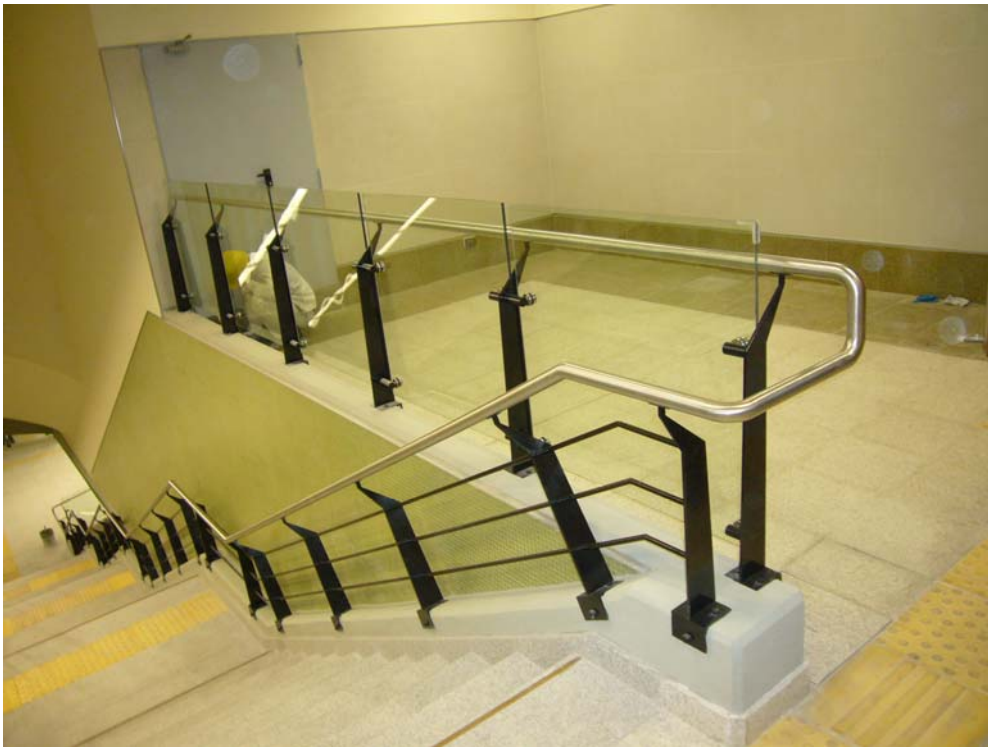
Foto 5- Parantes de baranda originalmente previstos en acero inoxidable, materializados en hierro pintado.
