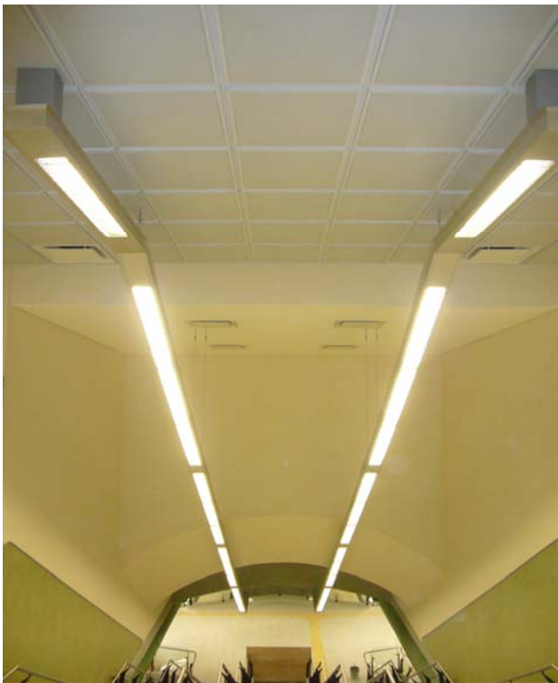
Foto 6- Artefactos de iluminación sostenidos con cables de acero, en lugar de los tensores rígidos previstos en el proyecto original.
